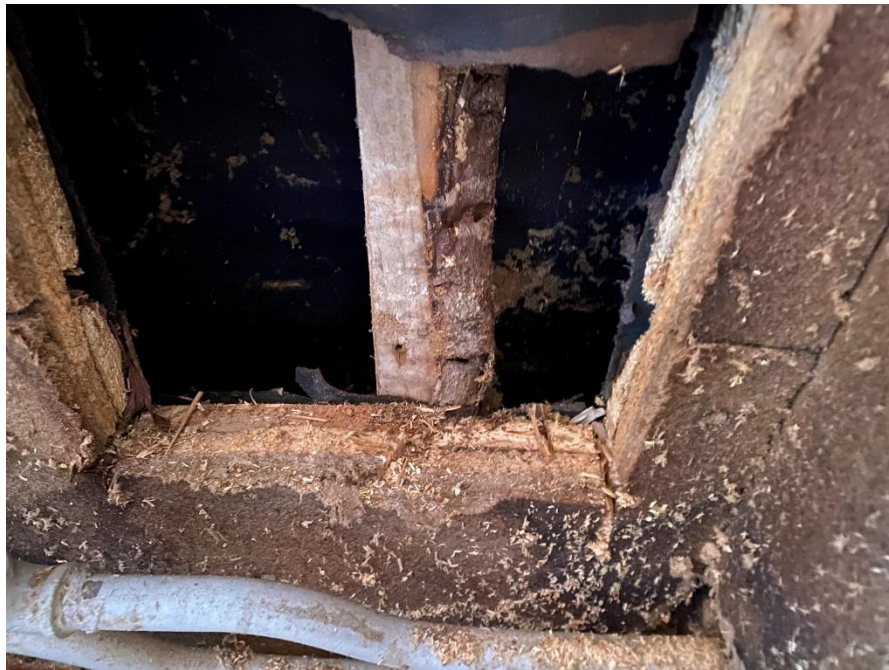
Kuva 16 Rakenneavaus [US6], seinän sisällä eriste painunut
