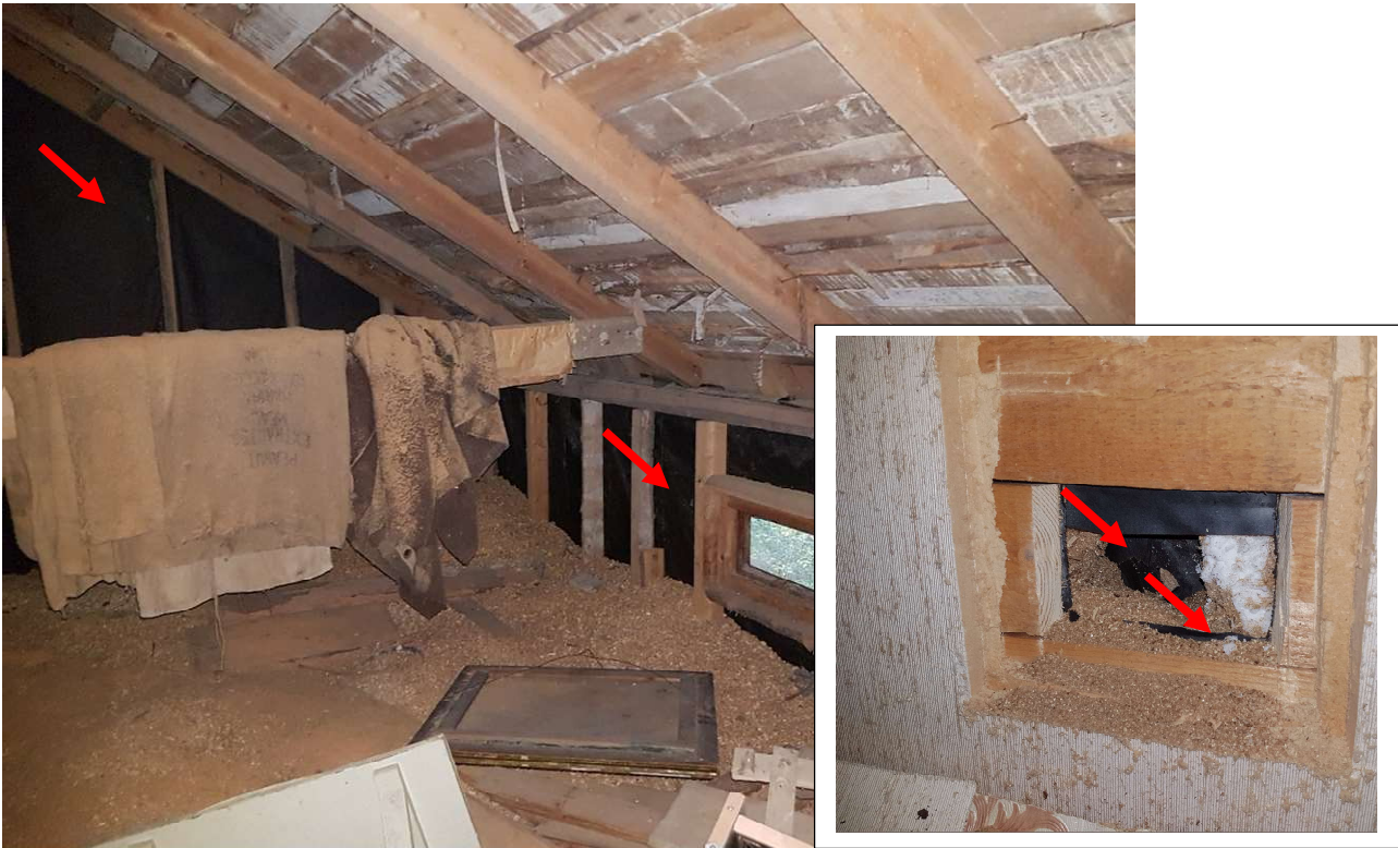
Kuva 3. Ulkoseinien tervapaperin PAH-summapitoisuus ylittää vaarallisen jätteen raja-arvon. Tervapaperia on käytetty ulkoseinän eristetilassa. Ainakin paikoittain tervapaperia on eristetilän sisä- ja ulkopinnassa (pieni kuva). Samaa paperia havaittiin paikoin myös väliseinärakenteissa.
