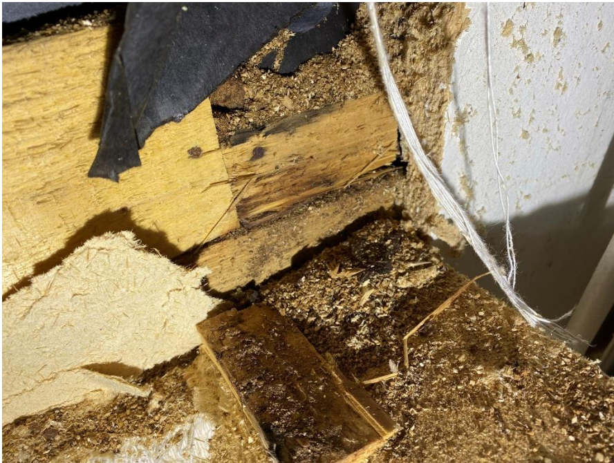
Kuva 11 Mikrobikasvua ulkoseinärakenteen sisällä [US1]
