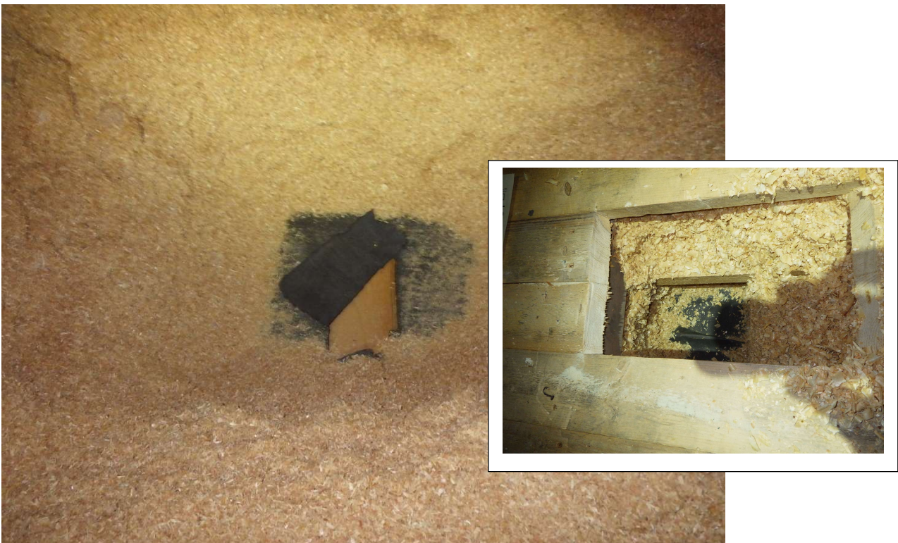
Kuva 4. Kuva yläpohjan ja välipohjan (pienempi kuva) eristetilosta. Yläpohjan ja välipohjan mustan ilmansulkukartongin PAH-summapitoisuus ylittää vaarallisen jätteen raja-arvon.
