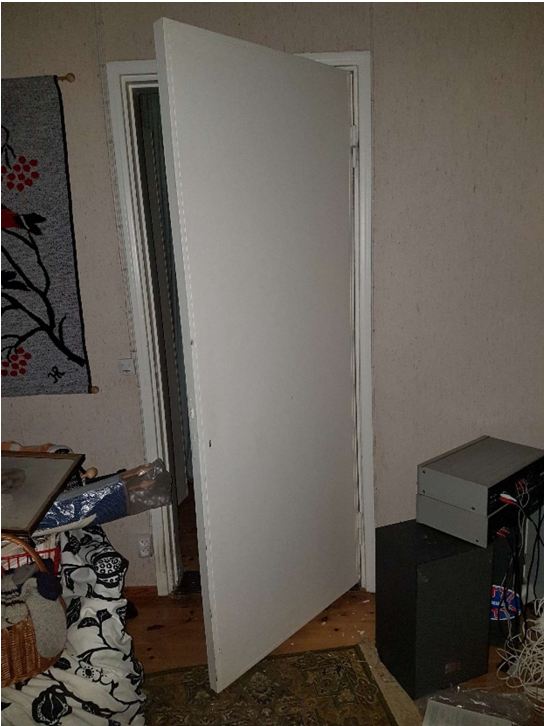
Kuva 7. Väliovien valkoinen maali ylittää raskasmetalleille asetettuja ohjearvoja.
