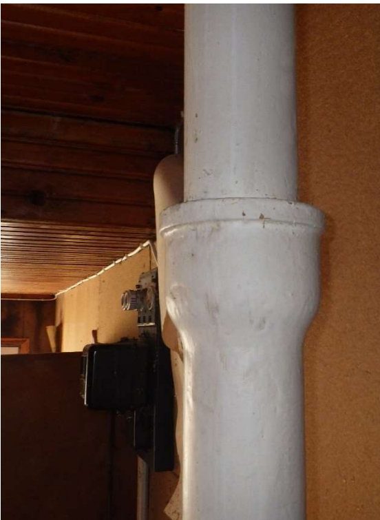
Kuva 8. Valurautaputken liitokset sisältävät runsaasti lyijyä (ei näytettä). Kuva on ullakkokerroksesta.
