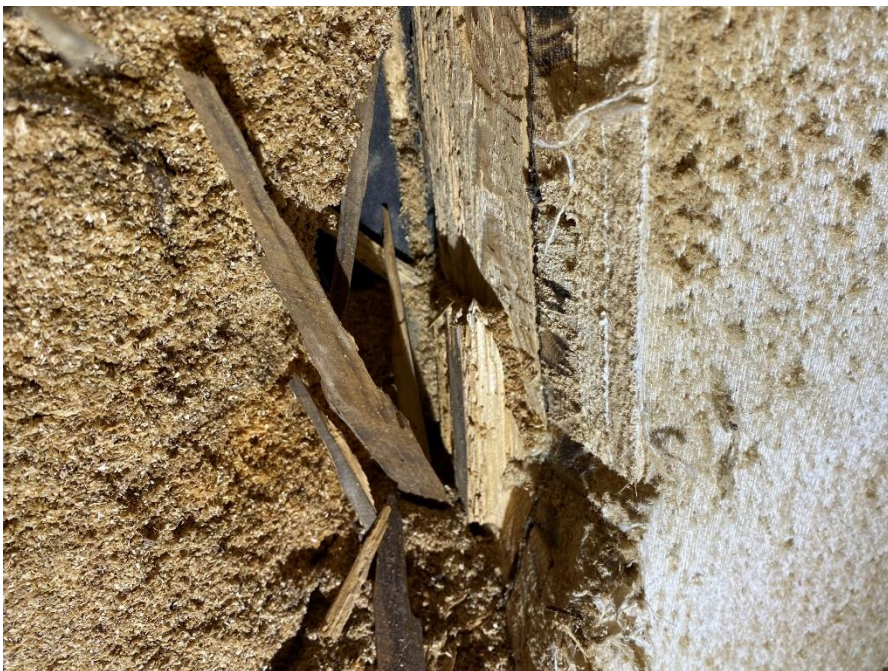
Kuva 12 Lahovaurioita ulkoseinän sisällä [US2]
