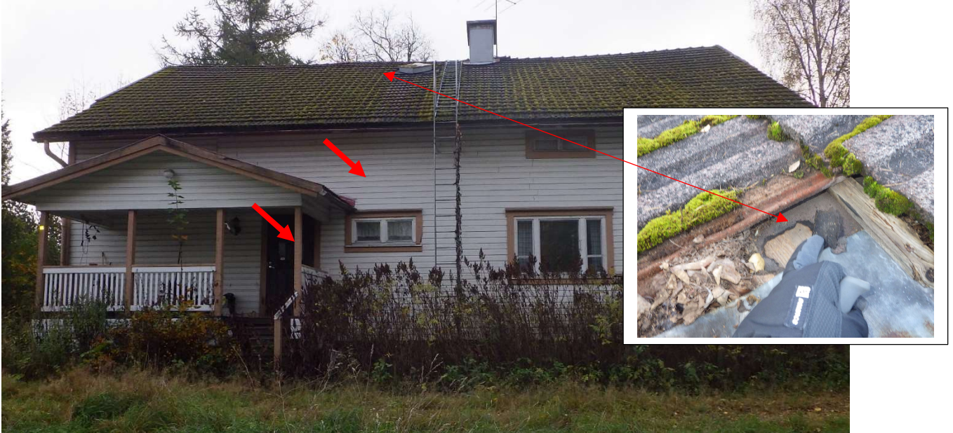
Kuva 1. Tiilikatteen alla oleva bitumikermän PAH-summapitoisuus ylittää pysyvän kaatopaikalle sijoitettavan jätteen raja-arvon. Valkoinen ja ruskea julkisivumaali ylittää raskasmetalleille asetettuja ohjearvoja (paksut nuolet).
