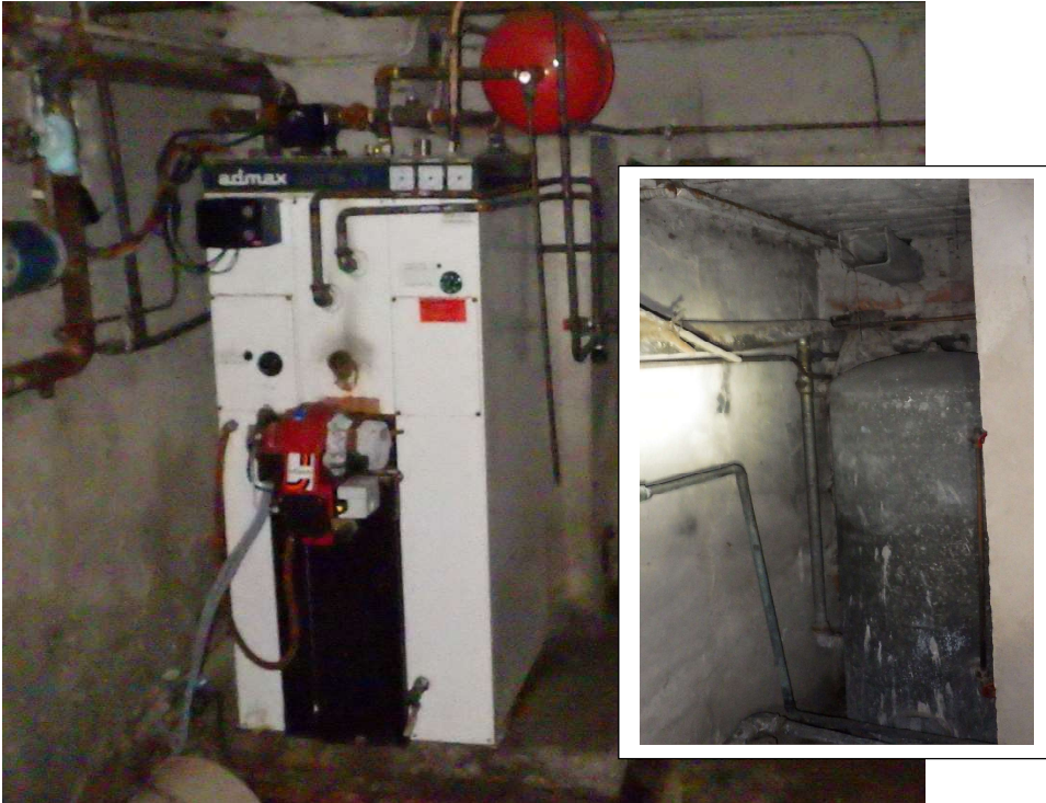
Kuva 9. Kellarikerroksen öljysäiliön ja öljykattilan eristeenä on saatettu käyttää asbestia ja niiden osat sisältävät todennäköisesti runsaasti öljyhiilivetyjä (ei näytettä).
