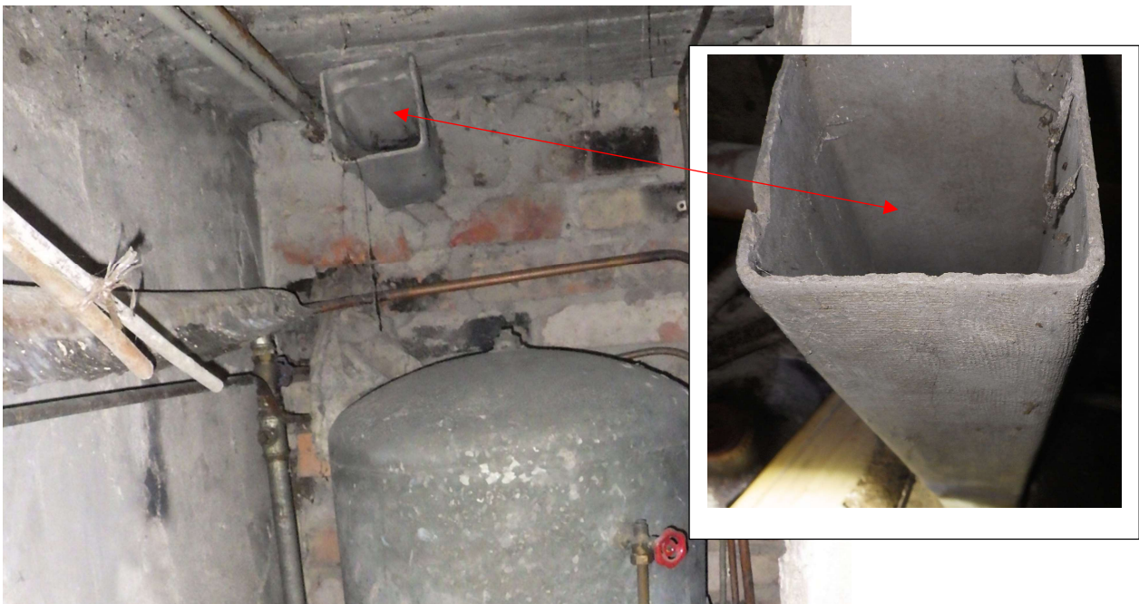
Kuva 2. Kellarissa havaitut kantikkaat ilmanvaihtokanavat sisältävät asbestia (ei näytettä).
