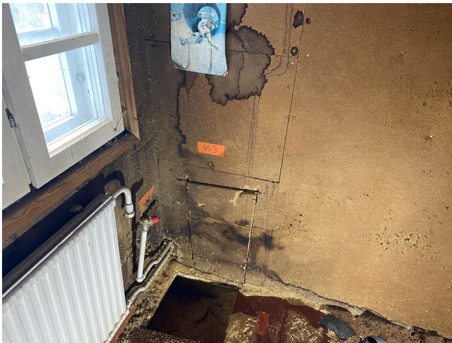
Kuva 24 Väliseinässä aistinvaraisesti havaittavissa viitteitä kosteusvauriosta [VS3]
