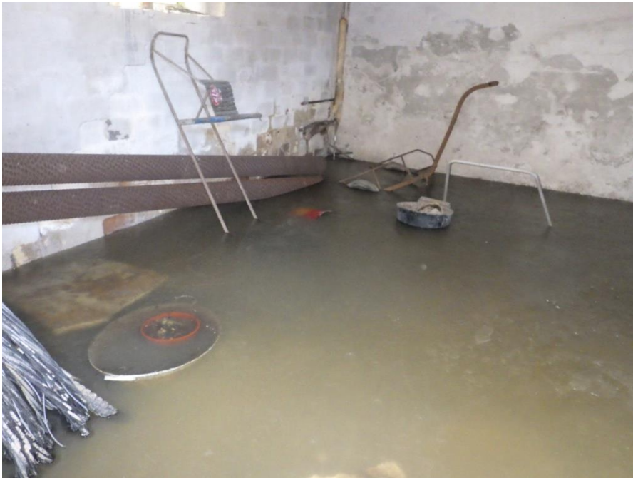
Kuva 2 Alapohjarakenne kellaritilassa veden peitossa
