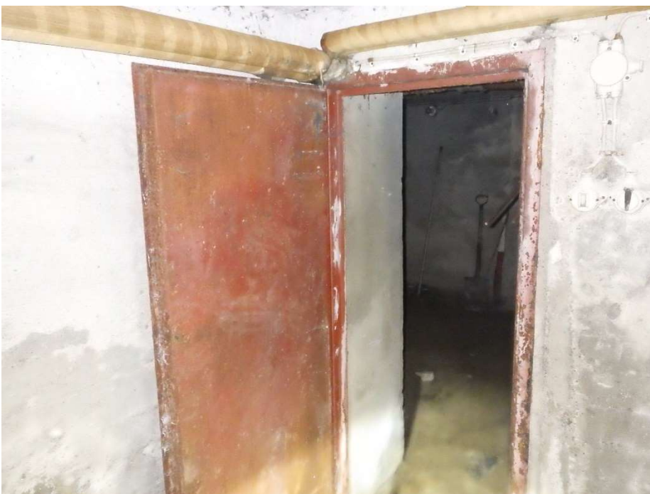
Kuva 10. Kellarikerroksen palo-ovet (3 kpl) saattavat sisältää asbestia (ei näytettä).
