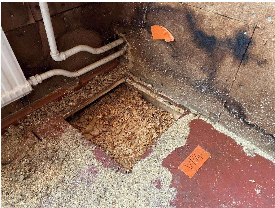
Kuva 22 Välipohjan rakenneavaus [VP4], rakenteissa viitteitä vesikattovuodon aiheuttamista kosteusvauriosta.
